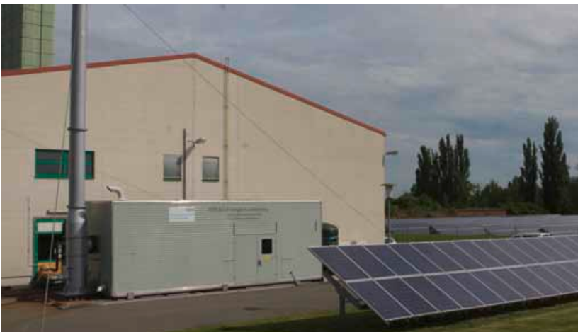
Gehört bald zum Bild aus vergangenen Tagen: Die mobile Energiezentrale.
