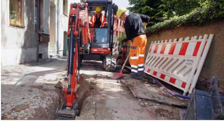
Bei den Arbeiten an der Trinkwasserhauptleitung in der Jungferngasse werden zusätzlich Strommuffen saniert.
