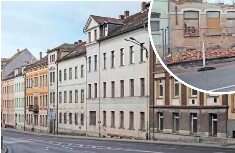
Alte Häuser haben Charme, entsprechen aber kaum modernen Anforderungen. Oft ist ein Neubau die bessere Alternative: Puschkinstraße 11–14 vorher und während der Abrissarbeiten.
