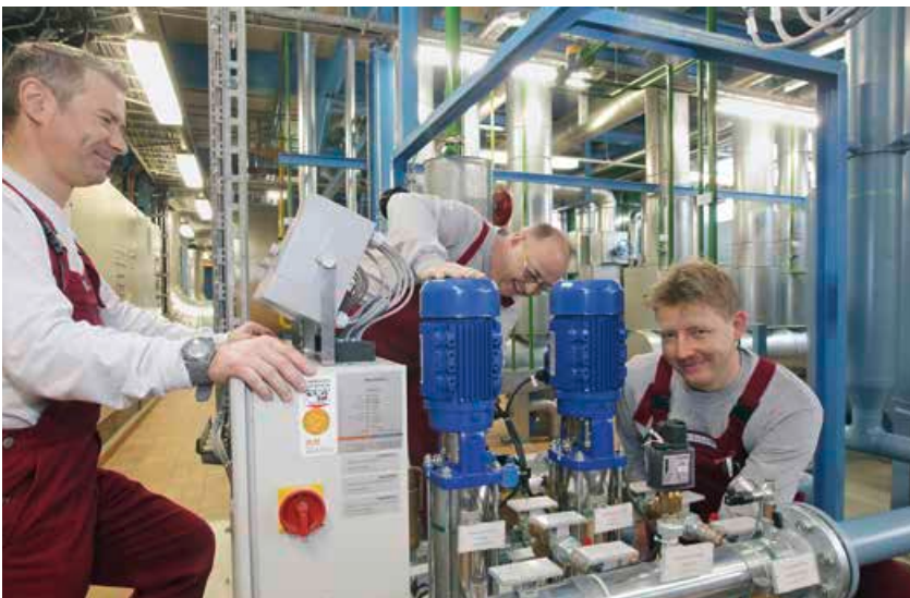
Großes Foto v. l.: Steffen Graichen, Dieter Grantner und Heiko Schuster im BHKW Südost beim Überprüfen der Pumpenleitungen, Foto r. o.: Ansicht des BHKWs Südost, Foto r. u.: Gasmotor.
