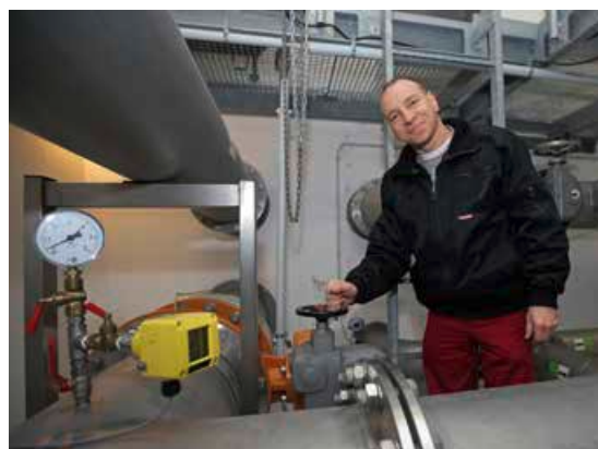
Matthias Spindler, Ewa-Monteur Fachbereich Wasser, im Technikbereich des Erdhochbehälters Wachtstange in Gleina.
