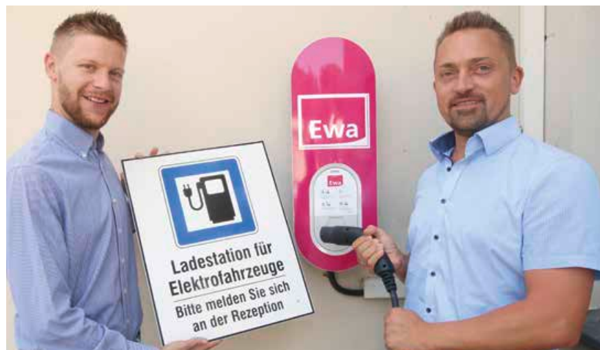
Hotel- und Restaurant-Chef Angelo Antonioli und Alexander Bräunlich von der Ewa bei der Installation der E-Ladestation, die Gäste des Parkhotels und des Restaurants „Da Angelo“ seit Juli nutzen können.
